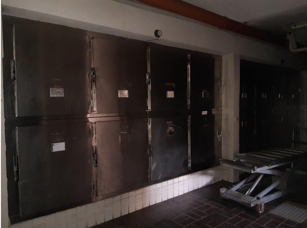
Foto: Sargkühlung im Keller der Aussegnungshalle
