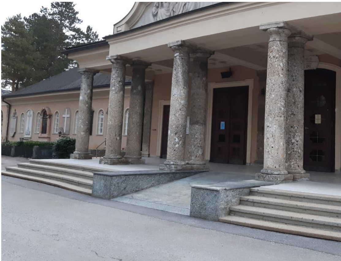
Foto: Zu steile Rampe ohne Handlauf bei Eingang zur Aussegnungshalle
